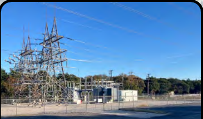
ONCOR POWER STATION (PLANTA ELÉCTRICA DE ONCOR)
